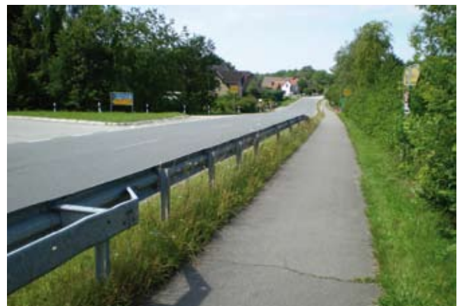
Die scharfkantigen Pfosten sind gefährlich
